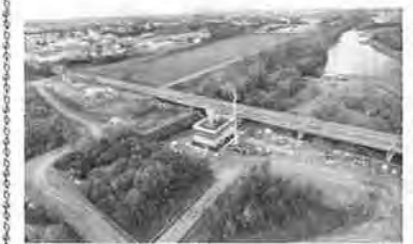
【工事】一般土木A 川西芽室音更線防B328改良(中島橋P1橋脚工) (伊藤・西江・生駒JV)
