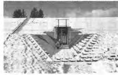
【工事】一般土木B・C 利別川改修(上流地区)陸別地区
