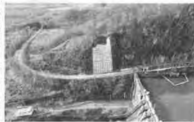
【工事】一般土木A 忠別清水線防B改良(落石対策工)(補正)
